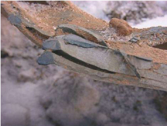
Рис. 4. Участок разрушенного по расслоению трубопровода
