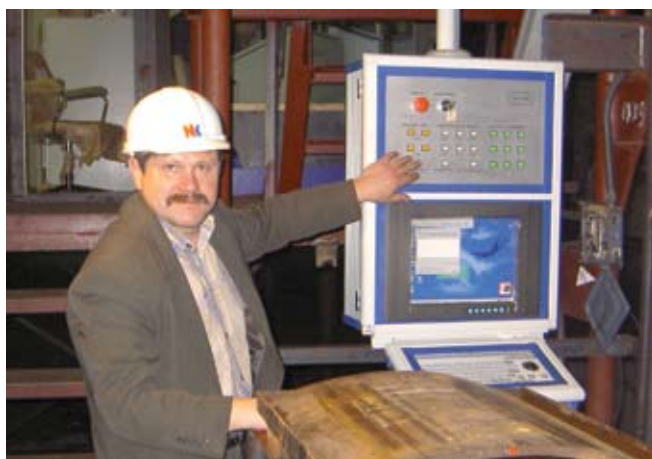
Фиг.13. Пульт управления установки «Волга-16-002» - ОАО «Челябинский трубопрокатный завод», г. Челябинск (Россия).
