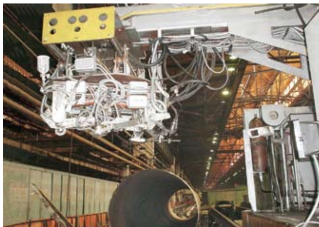
Фиг.10. Установка «Волга-1-16» для ультразвукового контроля спиралешовных труб - ОАО «Волжский трубный завод», г. Волжский (Россия).
