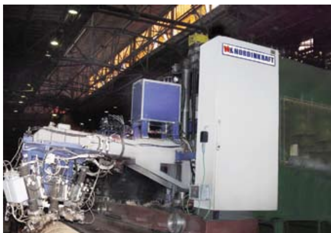
Фиг.11. Установка «Волга-16-002» для ультразвукового контроля спиралешовных труб - ОАО «Волжский трубный завод», г. Волжский (Россия).
